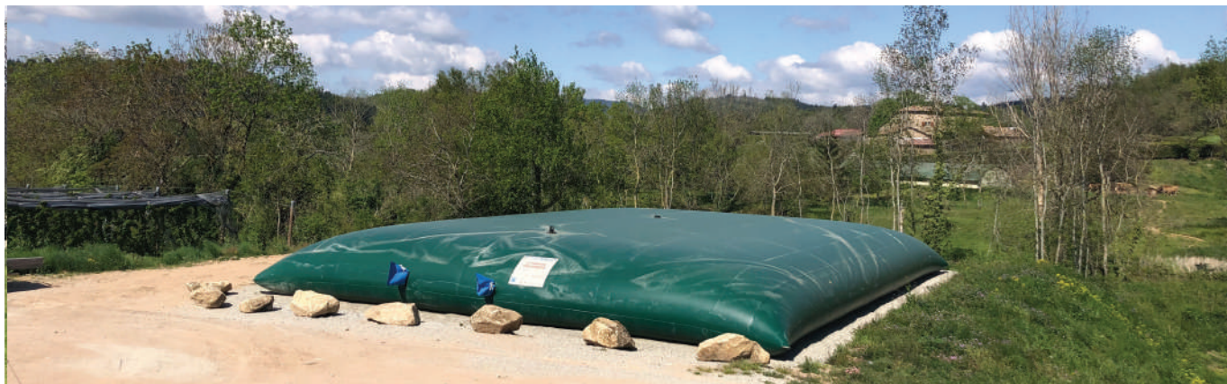
Une bâche à eau a été installée près de la Maison des artisans pour aider à la lutte contre le feu.
