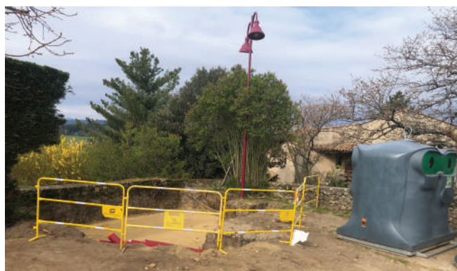
C'est à cet emplacement de l'avant-cour de la Mairie que sera bientôt installé le nouveau transformateur électrique.
